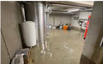
Ein technisches Gebrechen sorgte für Pumparbeiten.
